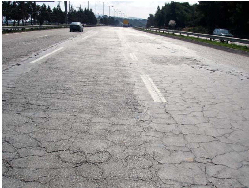
Φωτογραφία 1.1. Οδόστρωμα με εκτεταμένες αστοχίες
