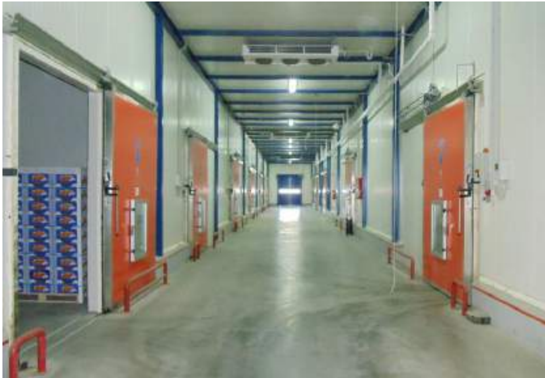
Εικόνα 63 Ψυκτικοί θάλαμοι (Πηγή: ALFA COOL HELLAS)
