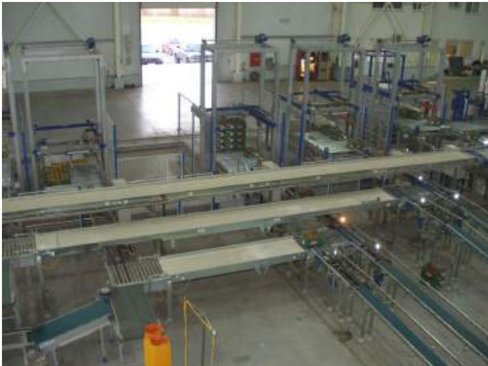
Εικόνα 53 Γραμμή αυτόματης παλετοποίησης (Πηγή; Novatec S.A.)
