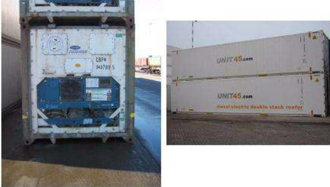
Εικόνα 81: Εμπορευματοκιβώτιο 45' με ηλεκτρική γεννήτρια [123]
