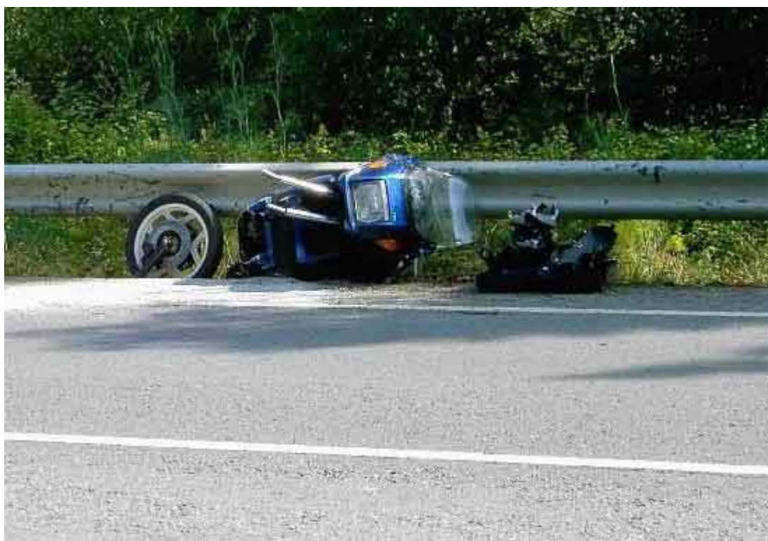
Εικόνα 37. Μεταλλικό στηθαίο ασφαλείας χωρίς οριζόντιο έλασμα
