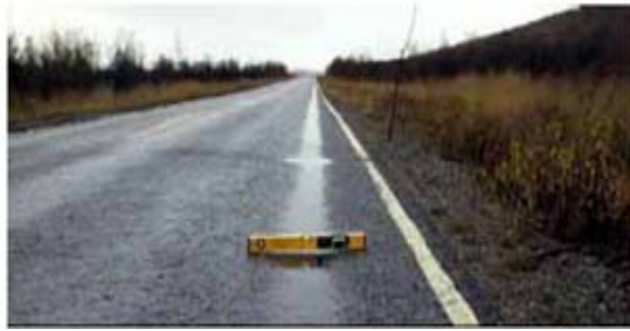
Εικόνα 2.9: Συσσώρευση νερού στο ίχνος τροχού (Dawson and Kolisoja, 2004)
