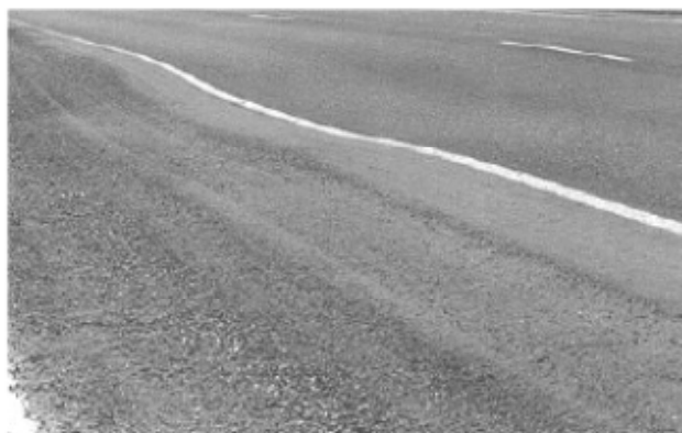
Εικόνα 2.10: Τοπική καθίζηση στην επιφάνεια ενός οδοστρώματος
