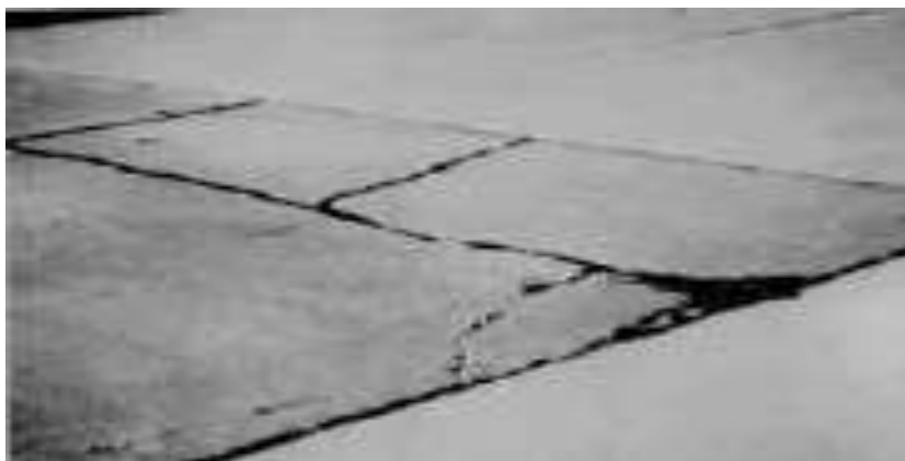
Σχήμα 7.18: Ενδεικτική κατάσταση πλάκας σκυροδέματος (τυπική διάρκεια ζωής)
