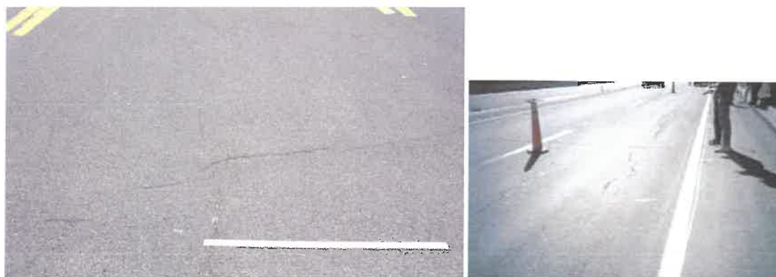
Σχήμα 3.5. Αλγατορικέσ ρηγματώσεις – Χαμηλό επίπεδο σοβαρότητας (Πηγές: Pavement Distress Identification Manual for the NPS Road Inventory Program, Cycle 4, 2006-2009 και Distress Identification Manual for LTPP, 2003)
