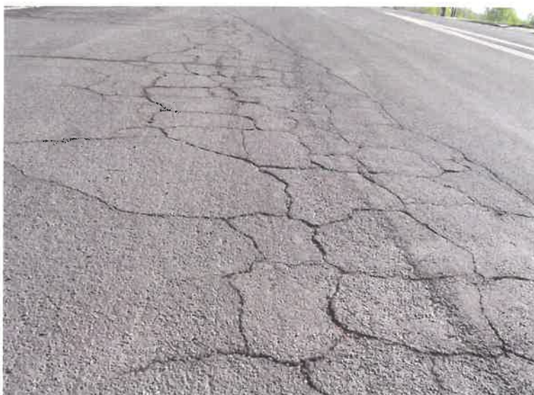
Σχήμα 3.6. Αλιγατορικές ρηγματώσεις – Μέτριο επίπεδο σοβαρότητας (Πηγή: Pavement Distress Identification Manual for the NPS Road Inventory Program, Cycle 4, 2006-2009)
