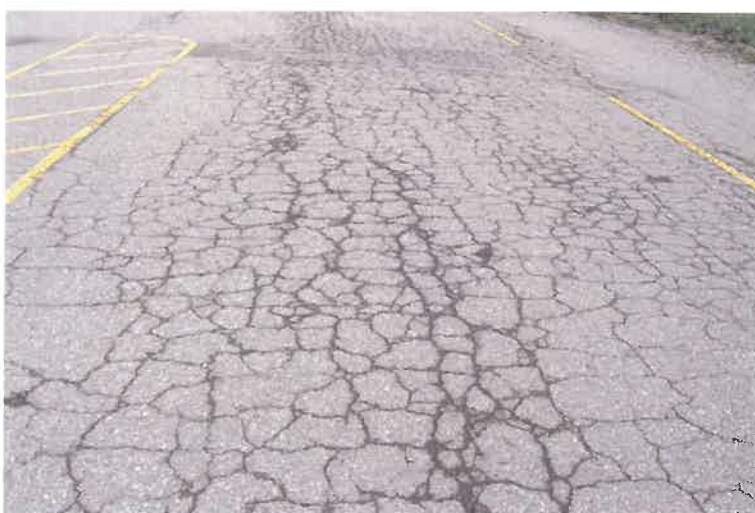
Σχήμα 3.7. Αλιγατορικές ρηγματώσεις – Υψηλό επίπεδο σοβαρότητας (Πηγή: Pavement Distress Identification Manual for the NPS Road Inventory Program, Cycle 4, 2006-2009)
