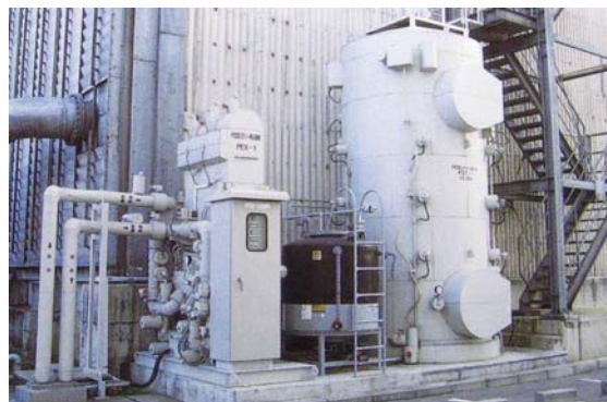
Εικόνα 3.6 : Εγκαταστάσεις Θέρμανσης (Πηγή: 2001 New Tokyo International Airport Environmental Report)
