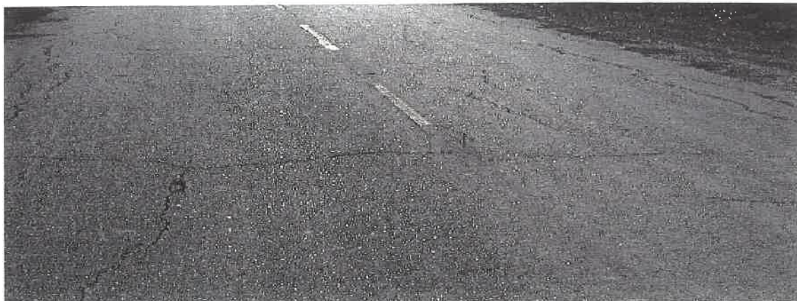
Σχήμα 2.3 Ρηγμάτωση του οδοστρώματος
