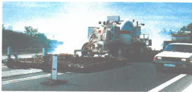
Εικόνα 1.8.10: Μηχάνημα ανακύκλωσης με ενσωματωμένη θερμαντική εστία [4]
