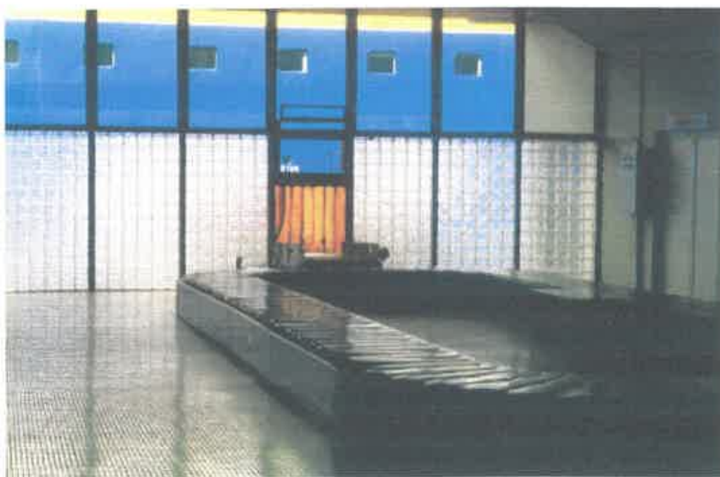
Εικόνα 3.1.ε. Μεταφορική ταινία με πλάκες (trace tracks) στον επιβατικό σταθμό του ΟΑΠ.
