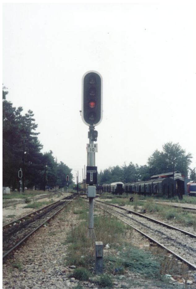
Εικόνα 2 : Φωτόσημα εξόδου παρεκκλίνουσας στο σταθμό του Λιανοκλαδίου
