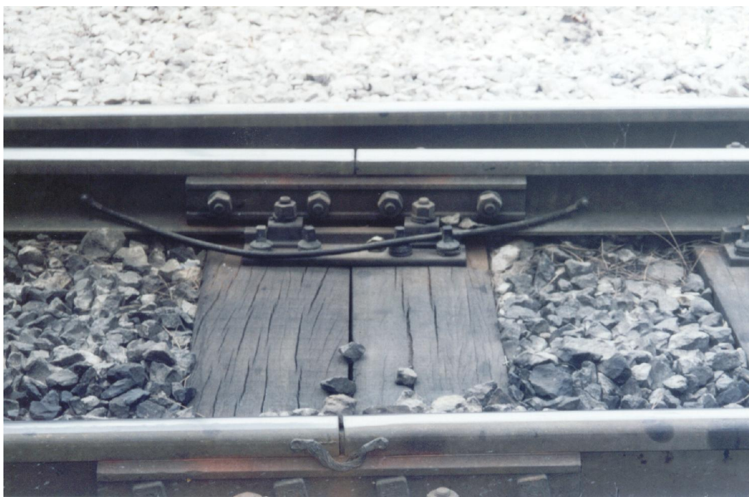
Εικόνα 5 : Σύνδεση μεταξύ των σιδηροτροχιών με αγωγούς, προκειμένου να επιτευχθεί ο προσδιορισμός της θέσης ενός συρμού.
