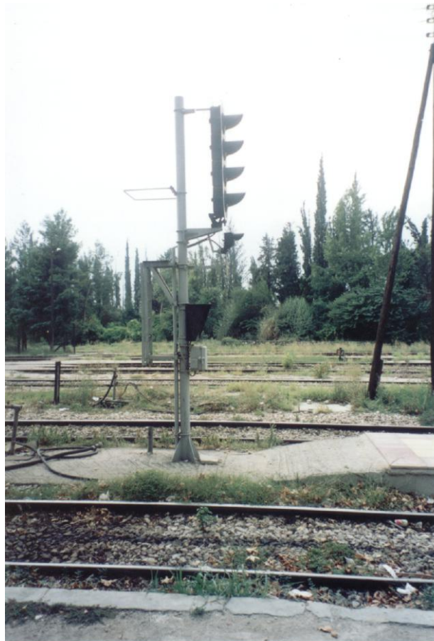
Εικόνα 3 : Πλάγια όψη φωτοσήματος εξόδου
