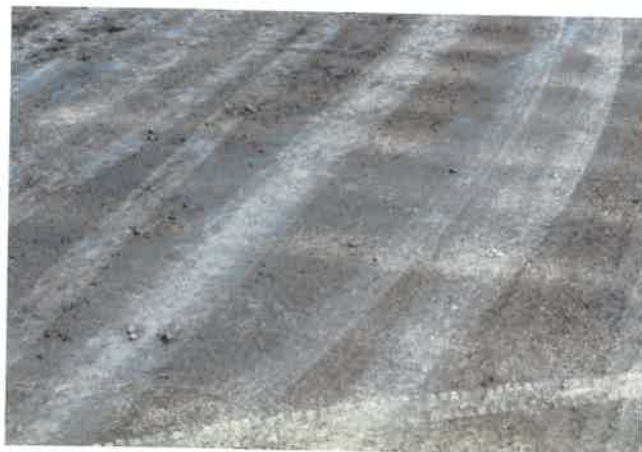
Εικόνα 11.38: Τροχιές των κινούμενων οχημάτων – μεταφορά κομματιών της στρώσης του γαλακτώματος συντήρησης σε μακρύτερα σημεία του δρόμου.
