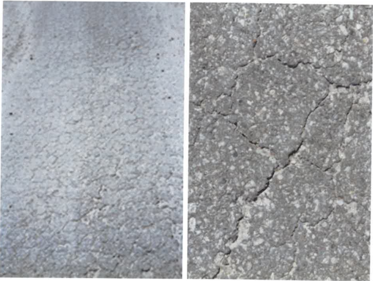
Εικόνα 11.1 και 11.2: Επιφάνεια με αλιγατορική, πυκνή ρωγμάτωση του προς ανακύκλωση δρόμου και λεπτομέρεια των αστοχιών λόγω κόπωσης
