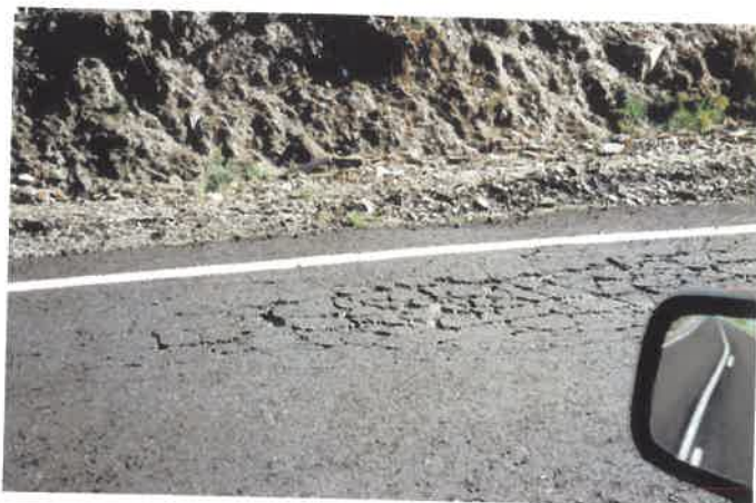
Εικόνα 11.46: Αστοχία του ανακυκλωμένου οδοστρώματος, ενδεχομένως λόγω έλλειψης τσιμέντου στο συγκεκριμένο σημείο (πιθανή στάση του ανακυκλωτήρα)
