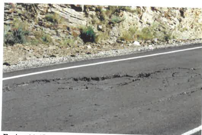
Εικόνα 11.47: Αστοχία λόγω κατολίσθησης των πρανών
