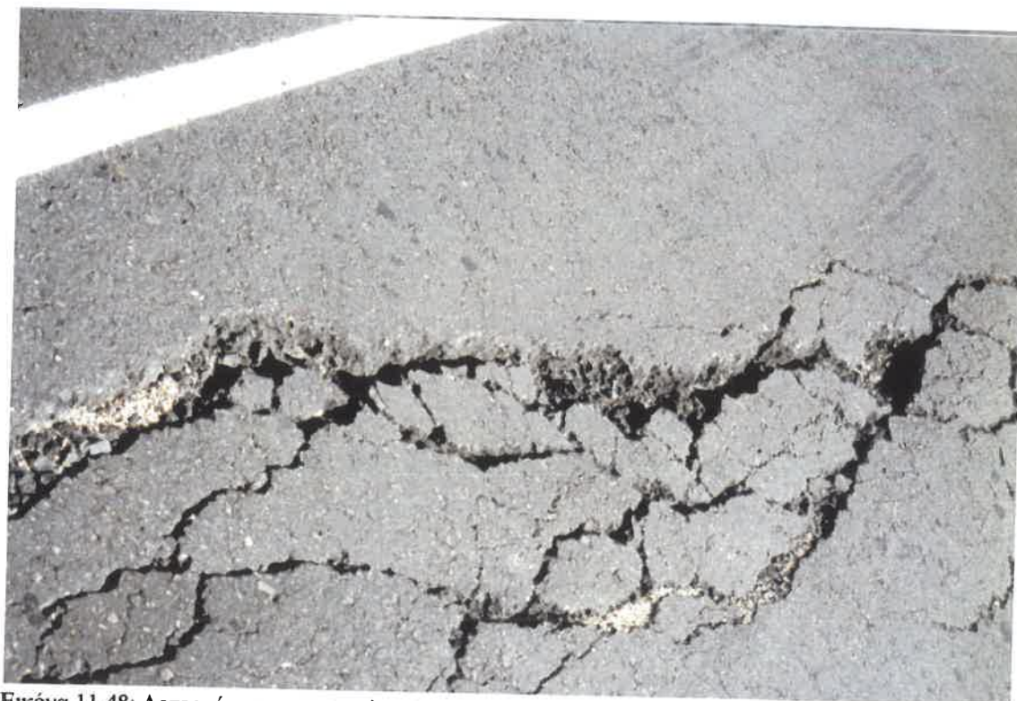
Εικόνα 11.48: Λεπτομέρεια της αστοχίας της εικόνας 11.47 - Ρωγμές μεγάλου εύρους
