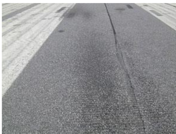
Εικόνα 2.9 Ενανθράκωση του ασφαλτικού υλικού
