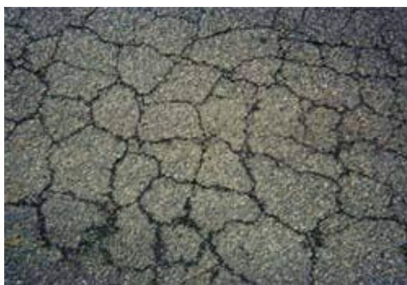
Εικόνα 2.3 Ρωγμή τύπου αλιγάτορα
