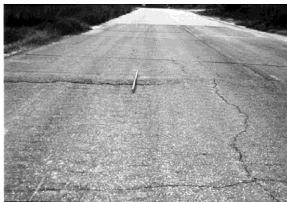
Εικόνα 2.7 Τοπική διόγκωση οδοστρώματος
