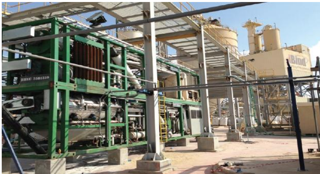
Εικόνα 5.9 Μονάδα παραγωγής στην πόλη Dimona του Ισραήλ
