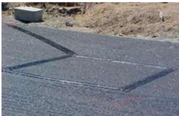
Εικόνα 4. 5: Απλός επαγωγικός βρόχος μετά την εγκατάσταση
