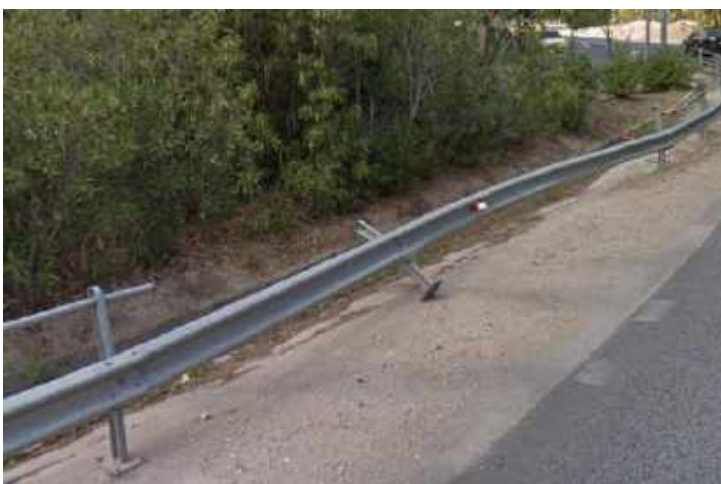
Εικόνα 4-13 Παραμορφωμένο προστατευτικό κιγκλίδωμα στο τέλος της ακτίνας R=110m
