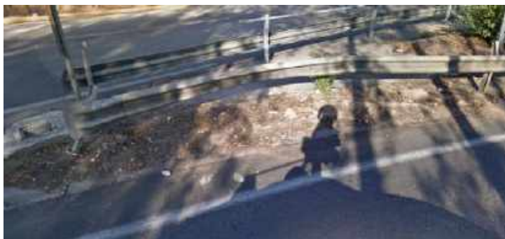
Εικόνα 4-11 Παραμορφωμένο προστατευτικό κιγκλίδωμα στην είσοδο του βρόχου με ακτίνα R=30m
