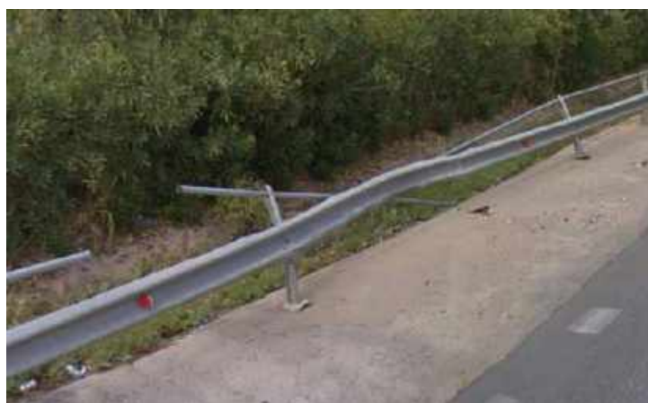
Εικόνα 4-12 Παραμορφωμένο προστατευτικό κιγκλίδωμα στην αρχή της ακτίνας R=110m
