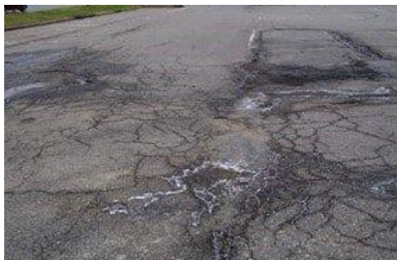
Εικόνα 4.7: Επίδραση βροχής σε εύκαμπτο οδόστρωμα
