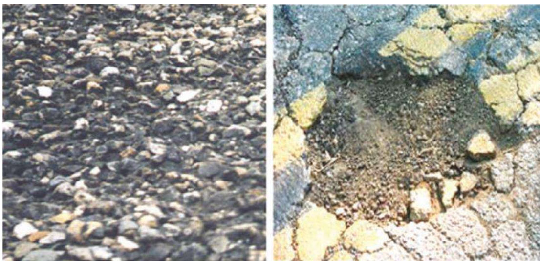
Εικόνα 5. 1 Βλάβες που προκλήθηκαν από την υγρασία στο οδόστρωμα α) αποφλοίωση β) λακκούβα Πηγή: Dawson, 2008
